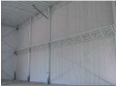
Fig. 22: Vista interior de panel en arreglo vertical.
