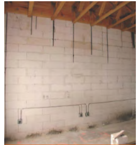
Fig. 27: Electrical conduits in Hebel® Wall.
